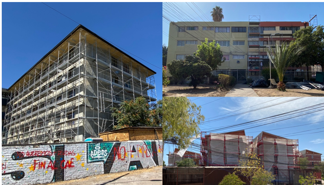
Figura 2. Edificaciones de vivienda colectiva en altura en trabajos de mejoramiento y reparación MINVU, Región Metropolitana, enero 2022.
