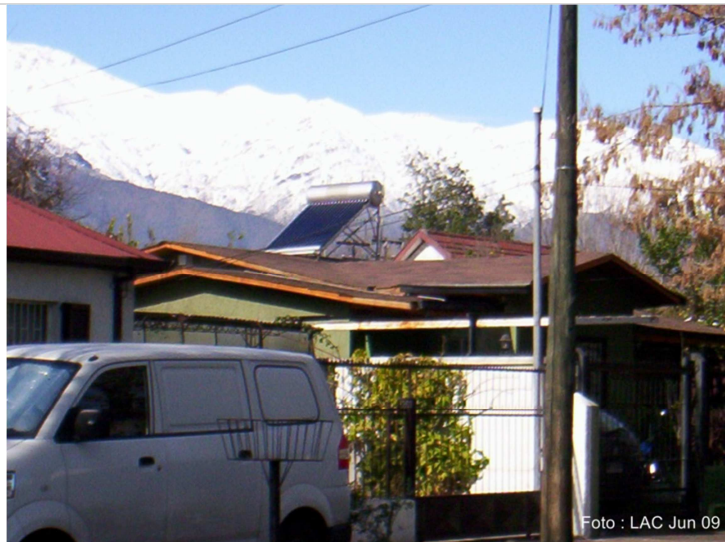
Figura 4: Instalación solar montada en techumbre de vivienda, pero ajena a una integración arquitectónica e intrusión en el paisaje. La Reina, ciudad de Santiago.
